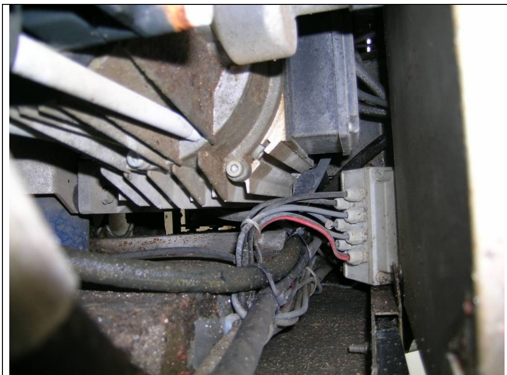
11: Et kig ind i teknikken til blandt andet højtryksrensere, som var meget velfungerende. Brugere er meget positivt mht. holdbarhed og funktion på denne del. Her er ingen tegn på rust og tæring, hvilket betyder at alt er velkonstrueret i gode materialer.
